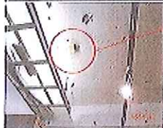
換気口付近・雨水配管付近、漏水の痕
